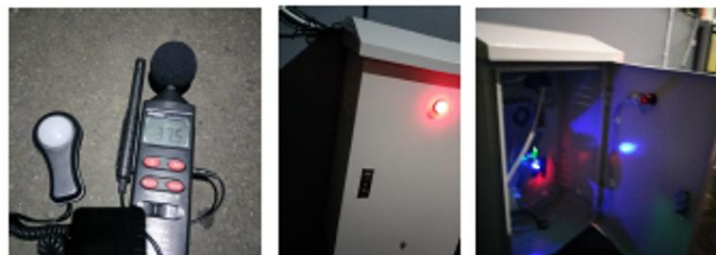
Gambar 9. Box Kendali Dan Telemetri Lampu COB Serta Pengukuran Luminasi
