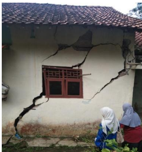
Gambar 8. Rumah Warga yang Mengalami Kerusakan Akibat Pergerakan Tanah
